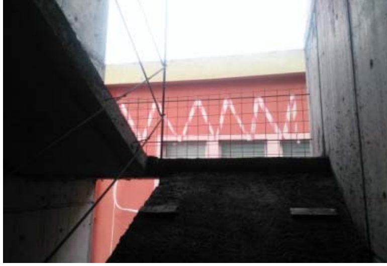
Şekil 4. Merdiven Yüksekten Düşme Riski Mevcut Durum
